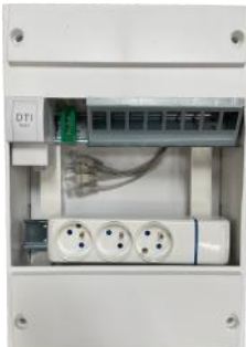
Coffret avec 3 prises électriques.
