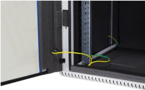
Précâblage de la terre
