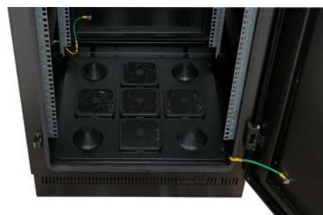
Mise à la terre
